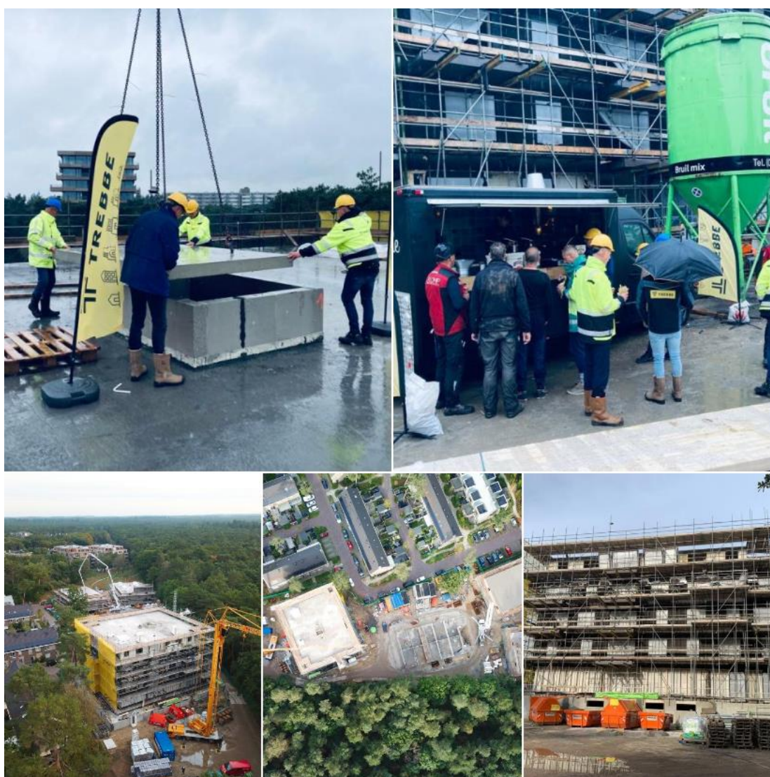
Hoogste punt bereikt in de bouw van de 27 sociale huurappartementen Bosgaarde Zeist
